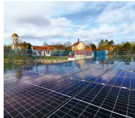
Die im Jahr 2021 mit 465 kWp in Betrieb genommene PV-Anlage auf den Dächern des Schulzentrums in Sinsheim erzeugt jährlich mehr als 12 Mio. kWh Sonnenstrom. Mehr als 40 Prozent des gewonnenen Stroms wird in den Schulgebäuden verbraucht.
