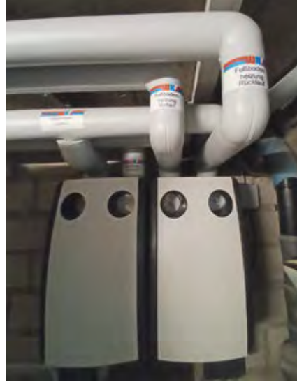
Warmwasser und Heizung werden getrennt gesteuert.
