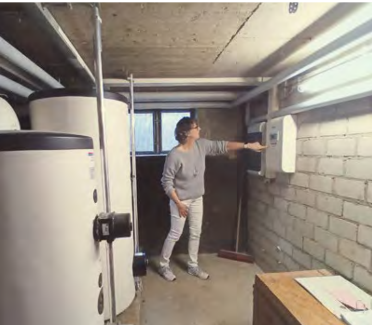
Wo vorher der Öltank stand, finden jetzt die Pufferspeicher für Warmwasser und Heizung Platz. Über den sogenannten Wärmepumpenmanager können Temperatur und Betriebszeiten eingestellt werden.
